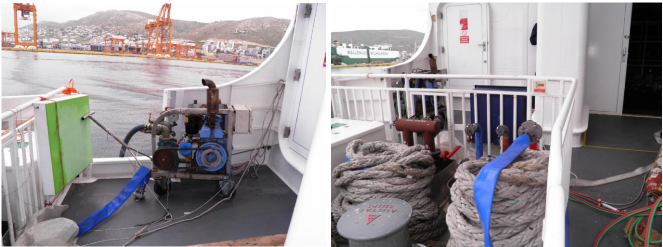
Εικόνες 4.4.4/1 & 2: Άποψη (1) της πετρελαιοκίνητης αντλίας πυρκαγιάς ανάγκης στη θέση της στο ανοικτό πρυμναίο αριστερό τμήμα του κυρίου καταστρώματος και (2) του άκρου της μάνικας την οποία θα τροφοδοτούσε, συνδεδεμένου στο δίκτυο πυρόσβεσης του πλοίου, μέσω του διεθνούς συνδέσμου ξηράς/πλοίου.
