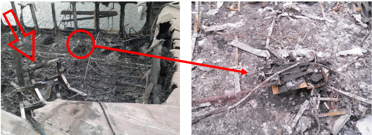
Εικόνες 4.1.1/12 & 13: Άποψη της αριστερής πλευράς του πρωραίου τμήματος του σαλονιού «Business» όπου η κατάρρευση της οροφής ήταν πλήρης. Έχουν επισημανθεί οι δύο (02) βάσεις Π.Σ.Σ. που είχαν τοποθετηθεί επί της οροφής πριν από την κατάρρευσή της καθώς και τα υπολείμματα της μηχανής ηλεκτροσυγκόλλησης που χρησιμοποιείτο από τους ελασματουργούς επί της οροφής και η οποία επίσης βρέθηκε στο κατάστρωμα «Upper Deck» μετά την κατάρρευσή της.
