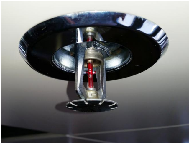
Εικόνα 4.4.3/1: Άποψη κεφαλής διασκορπισμού ύδατος του συστήματος «Sprinkler» του Ε/Γ-Ο/Γ-ΤΧΠ «ΧΑΪΣΠΙΝΤ 4». Διακρίνεται το θερμοευαίσθητο φιαλίδιο με το κόκκινο υγρό που διαστέλλεται θραύοντάς το επιτρέποντας τη ροή του νερού όταν η θερμοκρασία υπερβεί τους 68°C.
