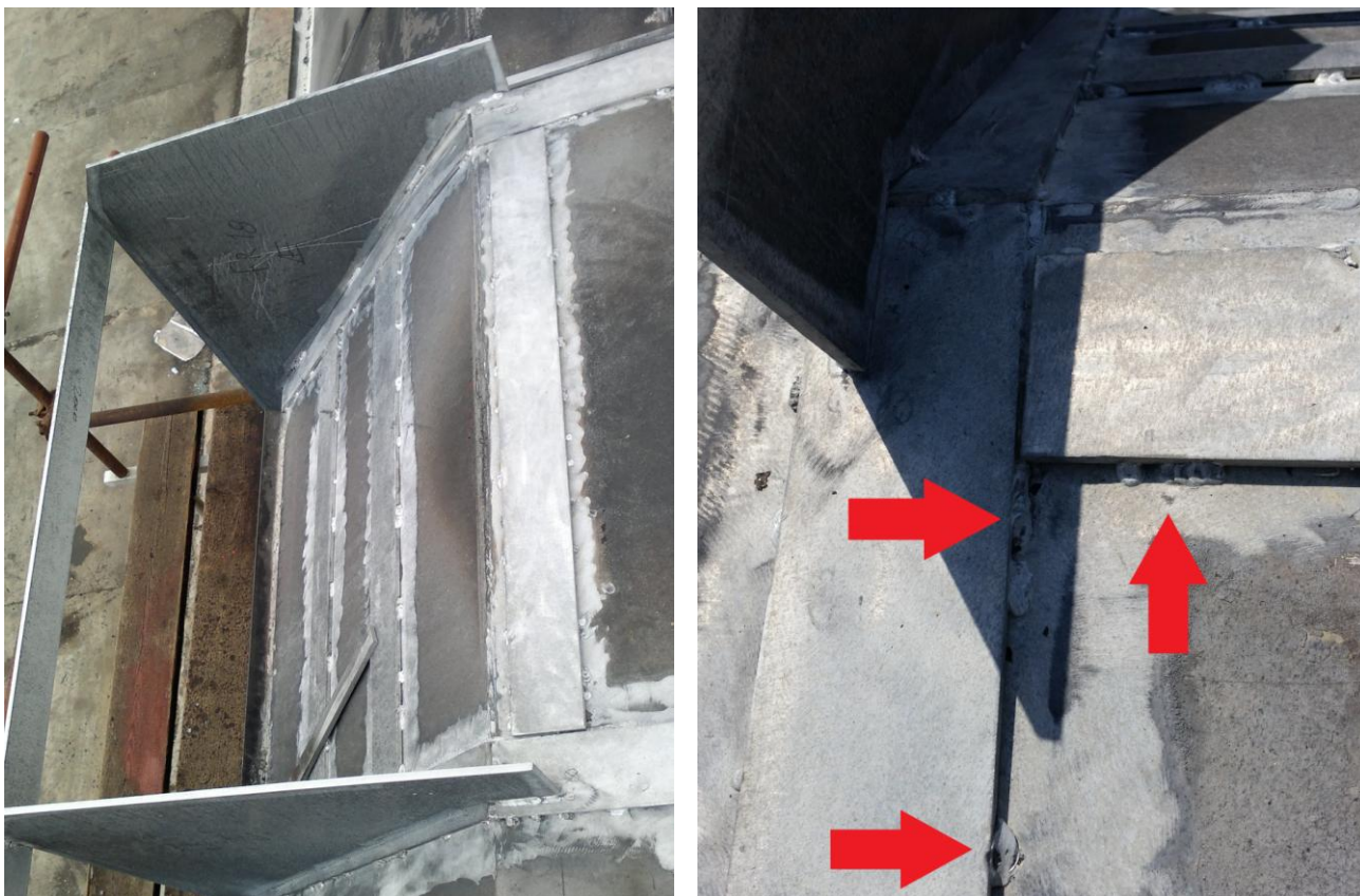
Εικόνες 3.1.2/3 & 4: Τεμάχια ενισχυτικών ελασμάτων της βάσης Π.Σ.Σ. (μεταξύ των Νομέων αριθ. 17-19), στην οροφή του χώρου επιβατών δεξιά, συγκολλημένα στις θέσεις τους με «πονταρίσματα».
