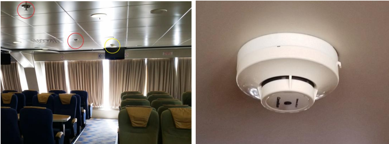
Εικόνες 4.4.1/1 & 2: Άποψη τμήματος του σαλονιού επιβατών του Ε/Γ-Ο/Γ-ΤΧΠ «ΧΑΪΣΠΙΝΤ 4», όπου έχουν επισημανθεί ένας ανιχνευτής καπνού (εντός κίτρινου κύκλου) και δύο κεφαλές του μόνιμου συστήματος πυρόσβεσης ύδατος «Sprinkler» (εντός κόκκινων κύκλων), όλοι κάτωθι της ψευδοροφής του χώρου. Στην εικόνα (2) φαίνεται ο τύπος των πυρανιχνευτών καπνού σε μεγέθυνση.
